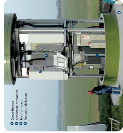
Composants électroniques dans le mât d'une éolienne
